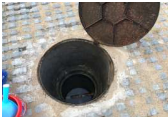
01 生活污水排放口
